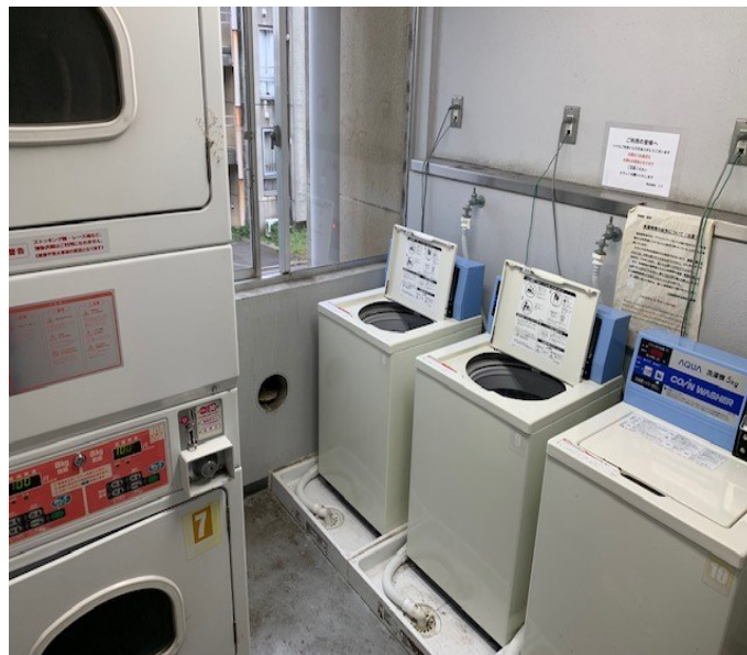
宿舎各棟 ランドリー室 （2階、3階）
