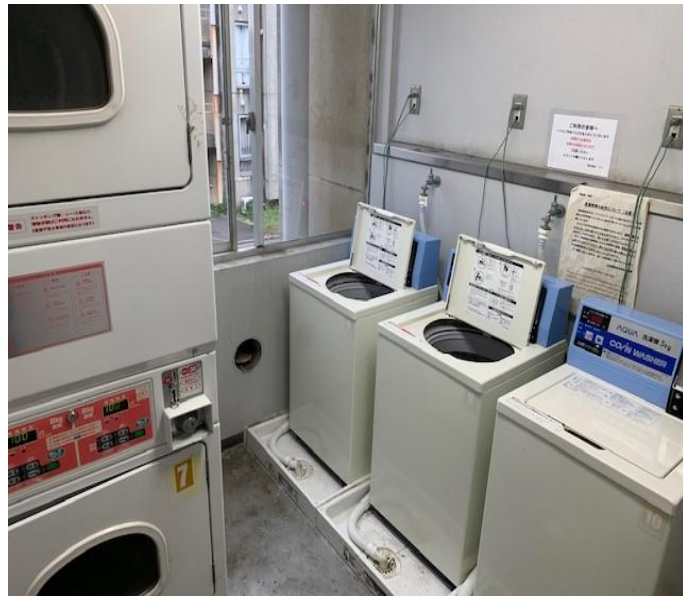
宿舎各棟 ランドリー室 (2階、3階)
