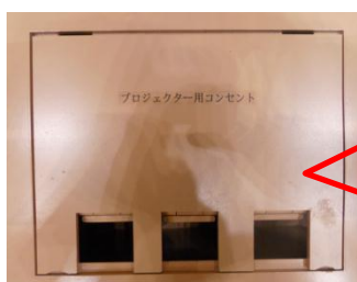
プロジェクター用床接続コンセント
