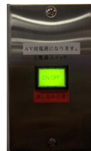
主電源スイッチ 電源ON時
