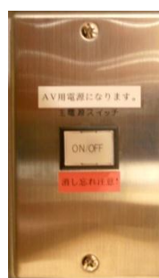
主電源スイッチ 電源OFF時
