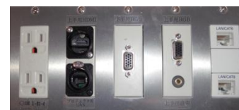
コンセント内部
