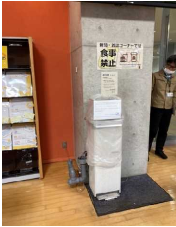
① 図書館1階ラウンジ ウォータークーラー有り 給排水・電源有り
