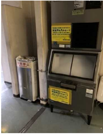
⑩ 第1体育館2階 ウォータークーラー有り 給排水・電源有り 隣接して製氷機有り
