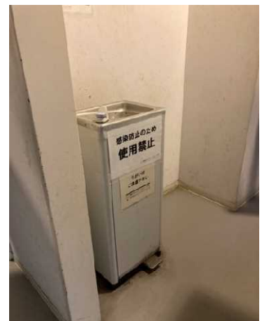
⑨ コミプラ(北館)1階 ウォータークーラー有り 給排水・電源有り
