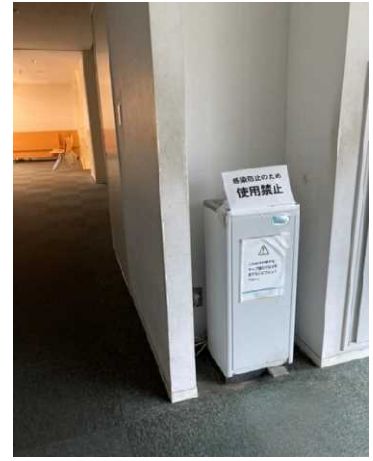
⑫ コミプラ(北館)2階 ウォータークーラー有り 給排水・電源有り
