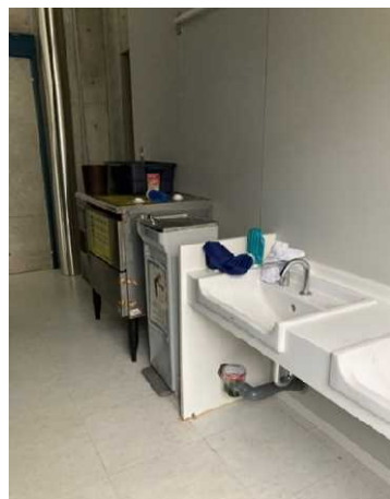
⑧ 第2体育館2階 ウォータークーラー有り 給排水・電源有り 隣接して製氷機有り
